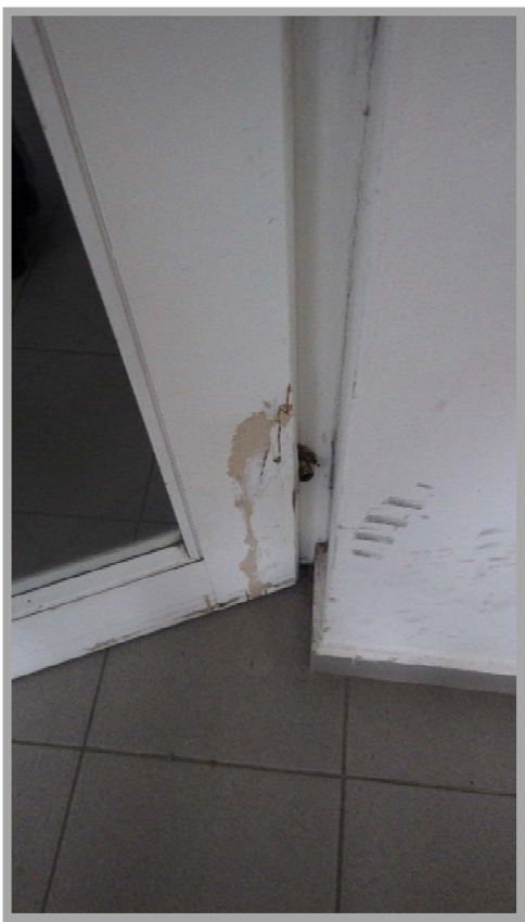
Obrázek č.8 : (Poškozené dveře a dveřní závěsy)
