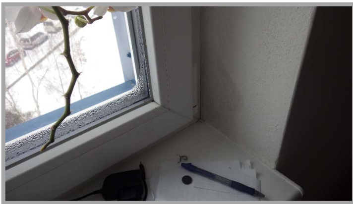
Obrázek č.5: (Zkondenzovaná vlhkost na skle a ostění okna)
