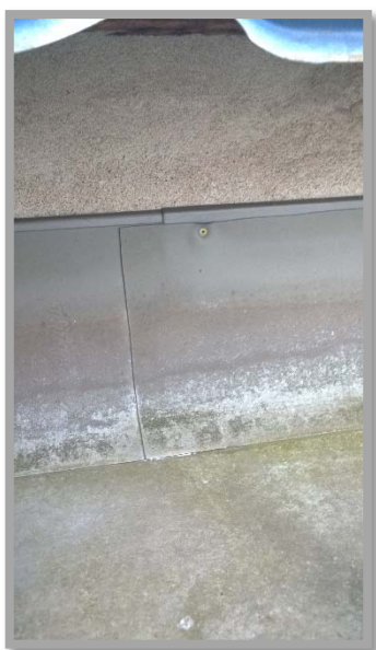
Obrázek č.10: (Nedostatečné vytažení střešní folie )
