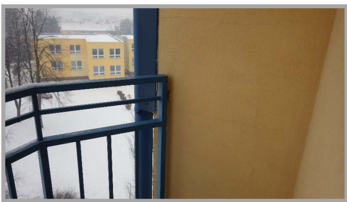
Obrázek č.4: (Trhliny na stěnách)
