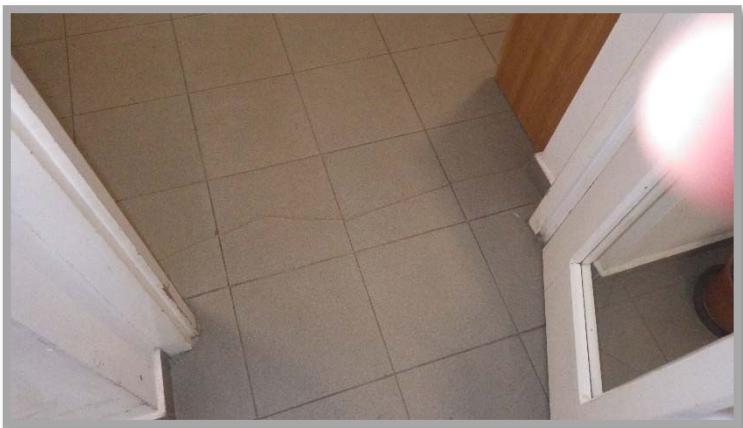
Obrázek č.9: (dilatační trhlina v keramické dlažbě)
