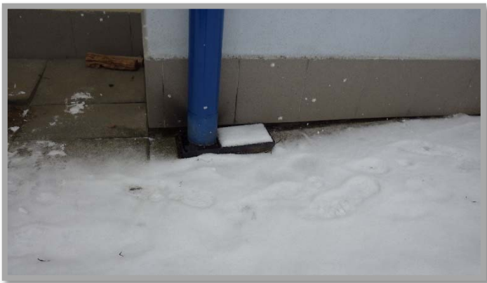
Obrázek č.3: (Pokles konstrukce okapového chodníku)
