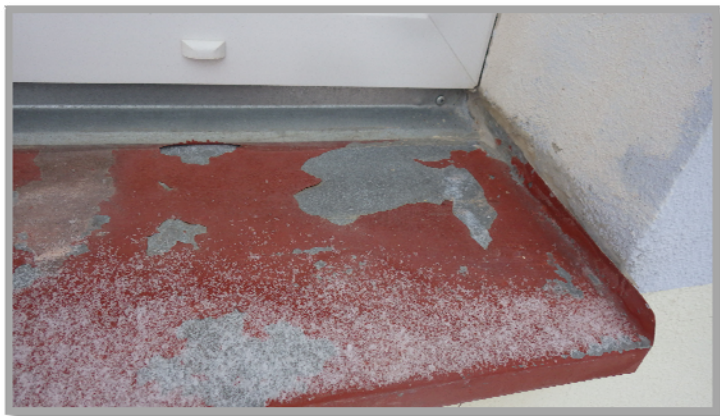
Obrázek č.6 : (Poškozená povrchová úprava parapetních plechů)
