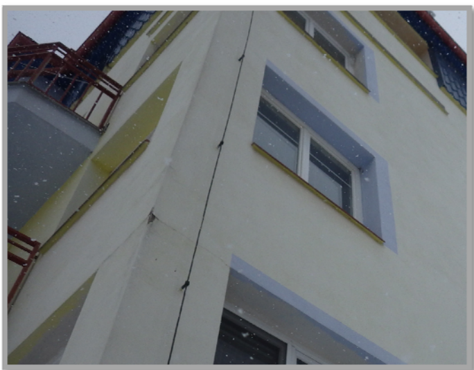
Obrázek č.3: (Trhlina v nároží)
