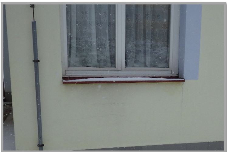
Obrázek č.4: (Trhliny na stěnách)
