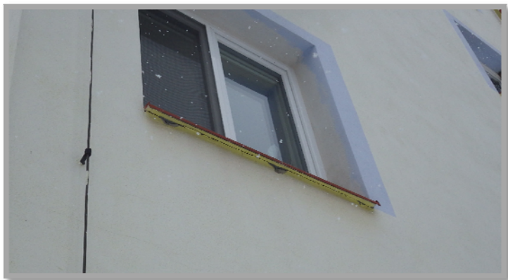
Obrázek č.7: (mezera mezi parapetním plechem a lůžkem)
