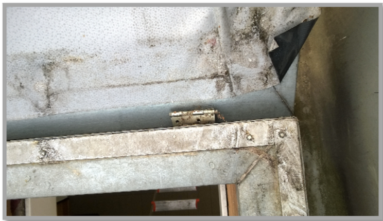
Obrázek č.11: (Střešní výlez – vylomený závěs)
