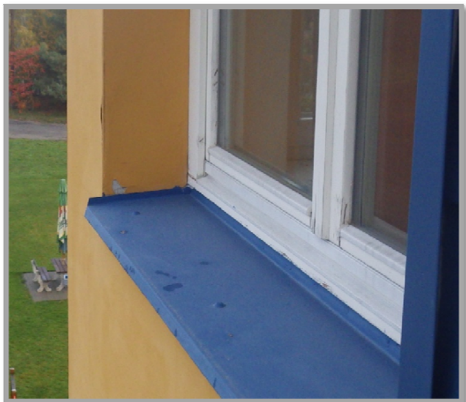
Obrázek č.6 : (Poškozená povrchová úprava oken)
