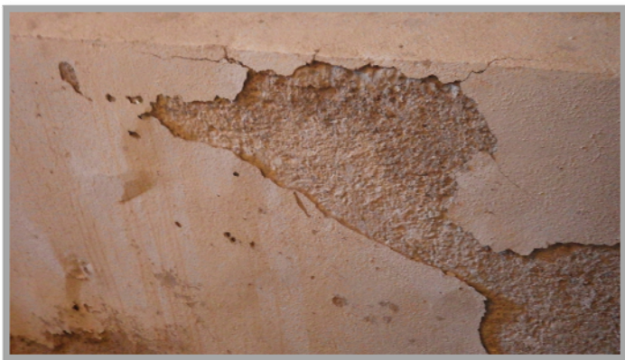
Obrázek č.2: (Sanitr na vnitřním líci suterénního zdiva)
