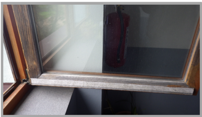
Obrázek č.6 : (Poškozená povrchová úprava oken)
