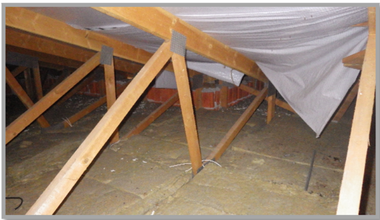
Obrázek č.9: (Nedostatečně provedená pojistná izolace)
