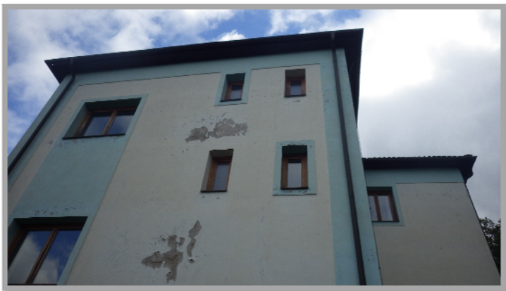
Obrázek č.3: (Pohled na fasádu s poškozenými omítkami)
